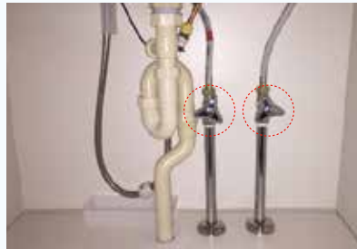
洗面化粧台水栓の止水栓
