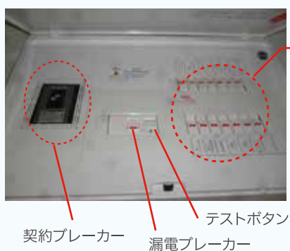
ブレーカー写真
