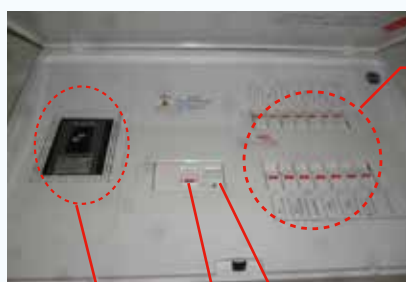
ブレーカー写真
