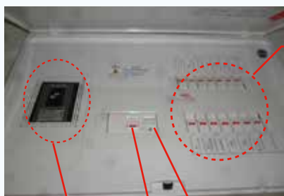
ブレーカー写真
